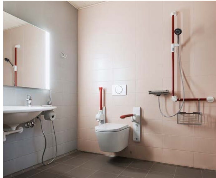
Kylpyhuoneissa on käytetty antimikrobisia wc-kalusteita tukikaiteineen ja wc-pesuistuin on elektroninen.
